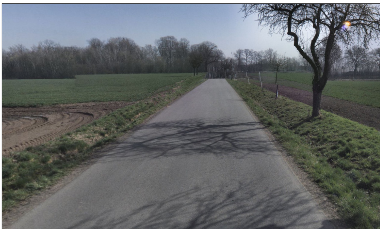
III/322 35 Medlešice – Dřenice – pouze krajnice
